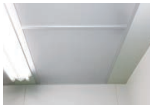
ルーム内吹出口 施行例
